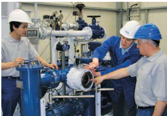
Inbetriebnahme und Schulung durch Lechler Mitarbeiter
