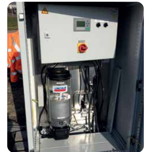
Kenőanyag ellátó rendszer szivattyúval, vezérléssel
